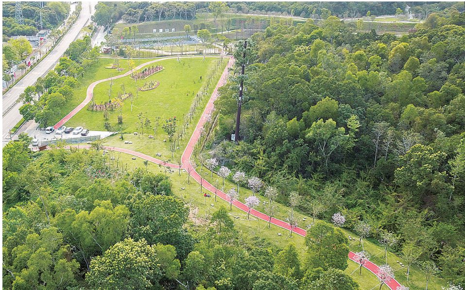
金岭路后山至丰树山段绿道建设工程。深圳侨报通讯员 吴依妮 摄
