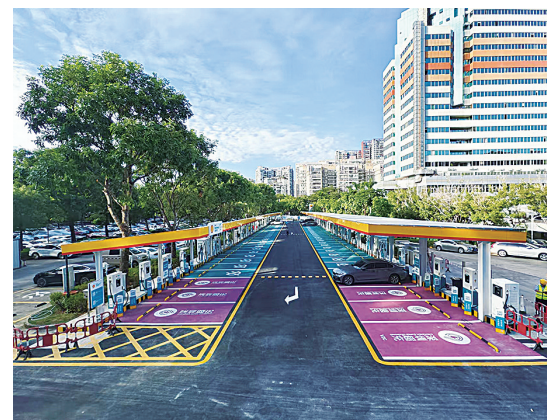
深圳龙岗海关大厦“光储充放”一体超充示范站。龙岗融媒资料图
